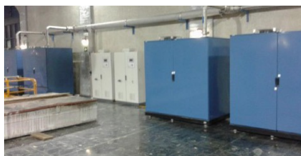
Ilustración 24. Cuadros de los compresores.
