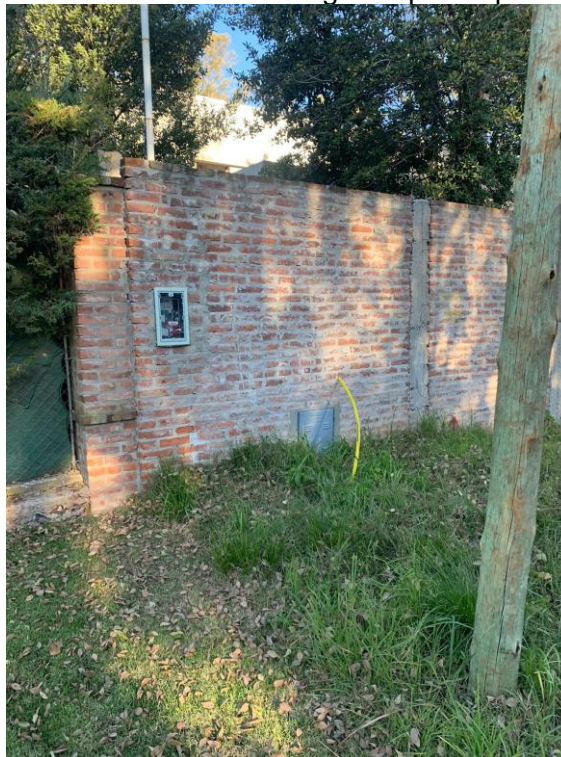
Foto 2. Vista en detalle del gabinete donde se proveerá el servicio de gas natural. También se verifica poste de tendido eléctrico y medidor de consumo eléctrico.
