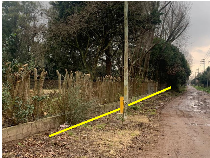
Foto 1. Vista del frente sobre la calle Dr. Nicolas Repetto a 25 metros de la calle R. Mendez. Sitio donde finaliza la instalación de la cañería sobre el lote N° 12. Se observa vereda de suelo natural y calle de tierra.
