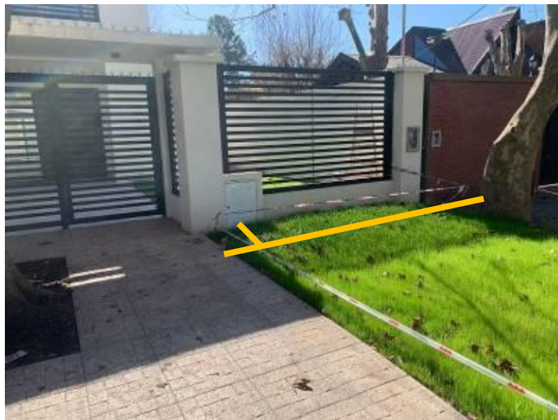
Fotografía 6. Vista del extremo de la red que alimentará a la vivienda ubicada en calle Del Facón N° 795.
